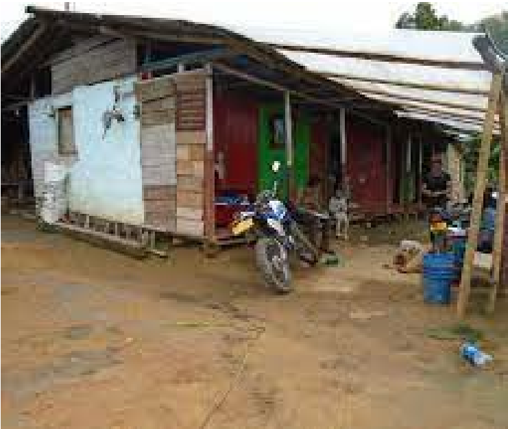
Vivienda rural con deficiencias constructivas y habitacionales
